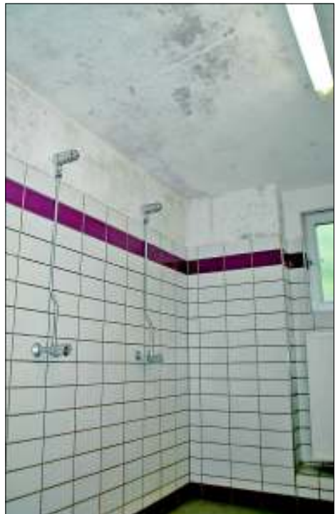
Schimmel an der Decke, Müffeln im Raum. Duschbaracke in der Jahnstraße. Foto: Mathes
